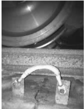
拱起处地基发生断裂
