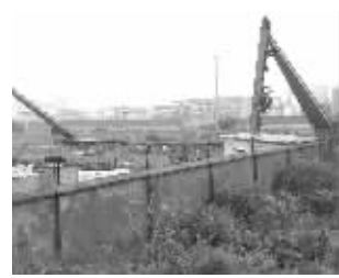
被风吹倒的龙门吊
