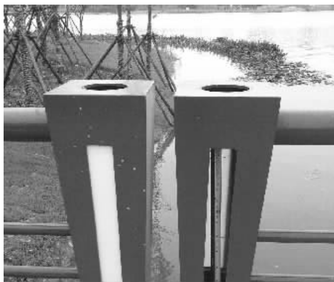
景观照明灯仅剩支架
