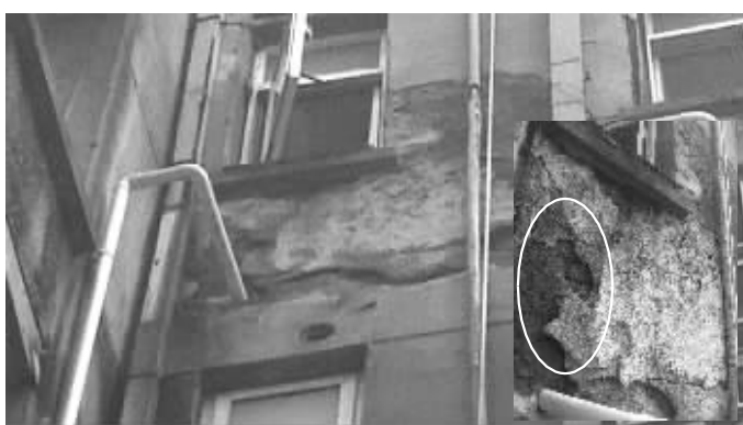
脱落的墙面已露出红砖 快报记者 曹玉兵 摄
