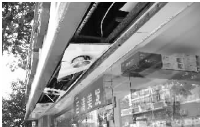
门头下的塑料扣板已经脱落
