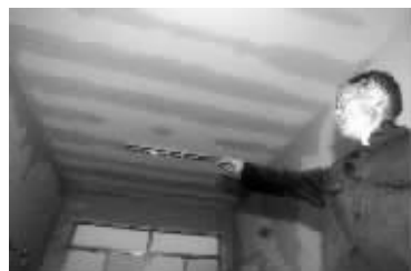
屋里漏雨严重 快报记者 顾炜 摄
