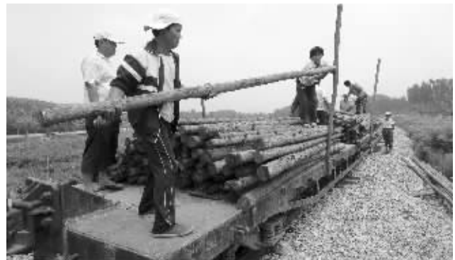
山东省乳山市遭受强降雨袭击,造成桃威铁路部分路段出现塌方。7月28日,施工人员正对塌方路段抢修。新华社记者 郭绪雷 摄
