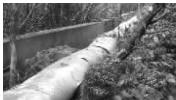
这就是发生泄漏的管道
