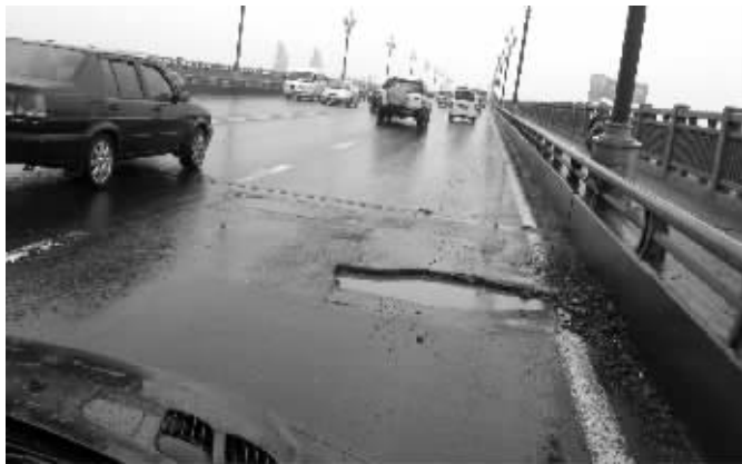
这样的大坑,大桥上有好多 快报记者 项风华 摄
