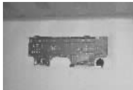
墙上的支架还在,空调没了
