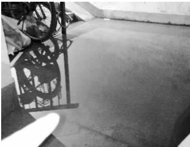
地下室的积水给业主们带来诸多不便
