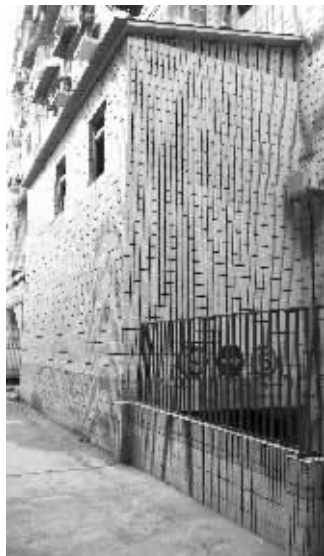
违建就盖在地下车库入口上
