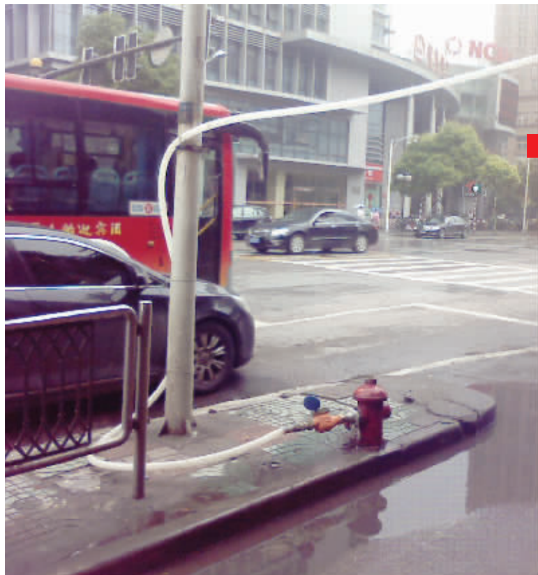
水管的一头接在消防栓上
