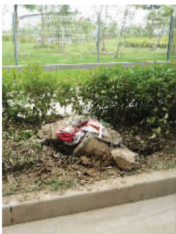
路灯被撞得只剩下水泥墩
