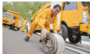
防汛新“武器” 快报记者 洪波 摄
