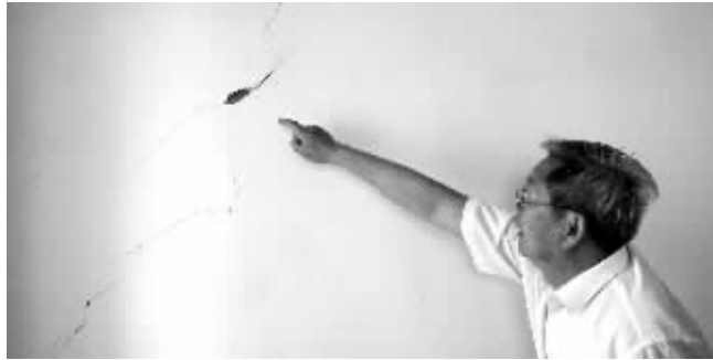
墙上的裂纹让尹先生很担心
