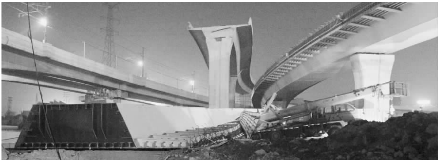
钢箱梁倾覆现场 快报记者 辛一 摄于2010年11月26日
