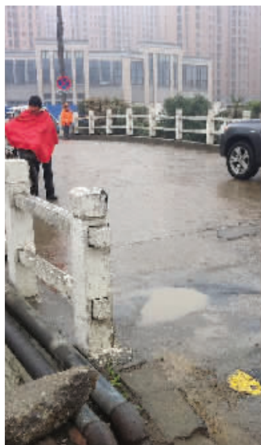
路面坑坑洼洼,这桥已成危桥
