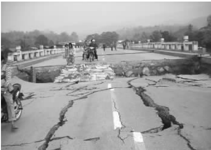
缅甸塔莱镇被震裂的一条道路 新华社/路透
