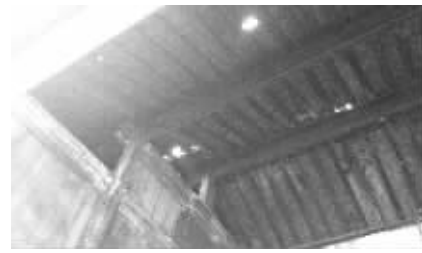
阳光从屋顶的漏洞里一泻而下，吴武壮公祠更显萧瑟与破败
