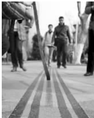
橡胶盲道已脱落 快报记者 顾炜摄
