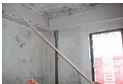
主、次卧室以及客、餐厅的吊顶,纵向没有安装轻钢龙骨来支撑加固
