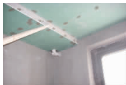
厨房吊顶侧面没有用防水石膏板
