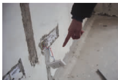
线路乱拉乱接现象随处可见,存在着比较严重的安全隐患
