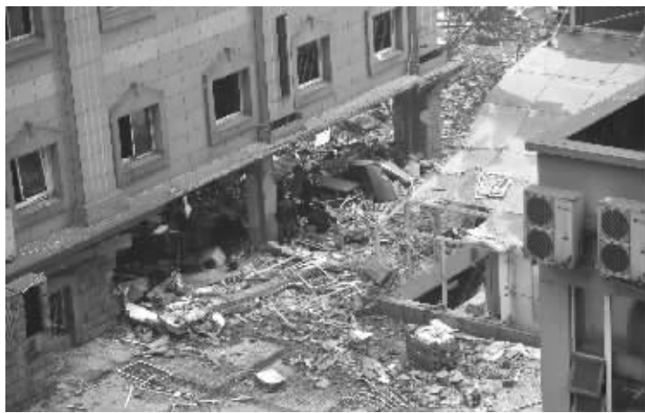
食堂的围墙被全部推倒损毁
