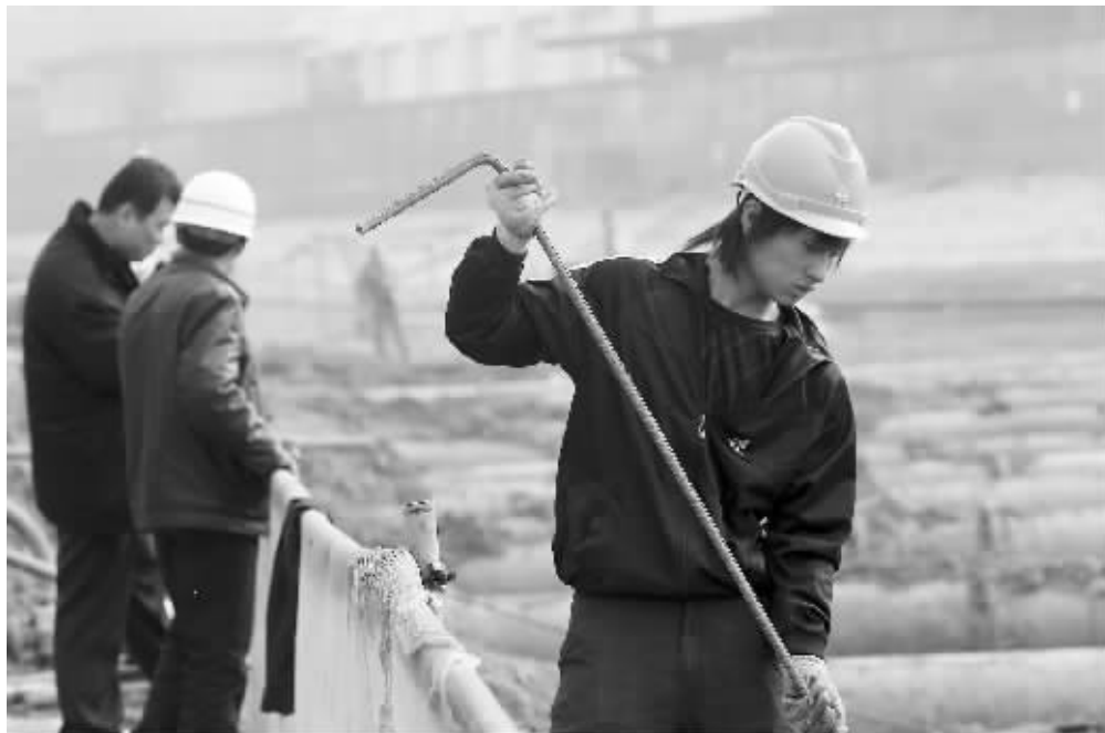
2月6日,金川河附近的工地,虽然正值新年假期,工人们依然忙碌着 本组摄影 快报记者 辛一 摄
