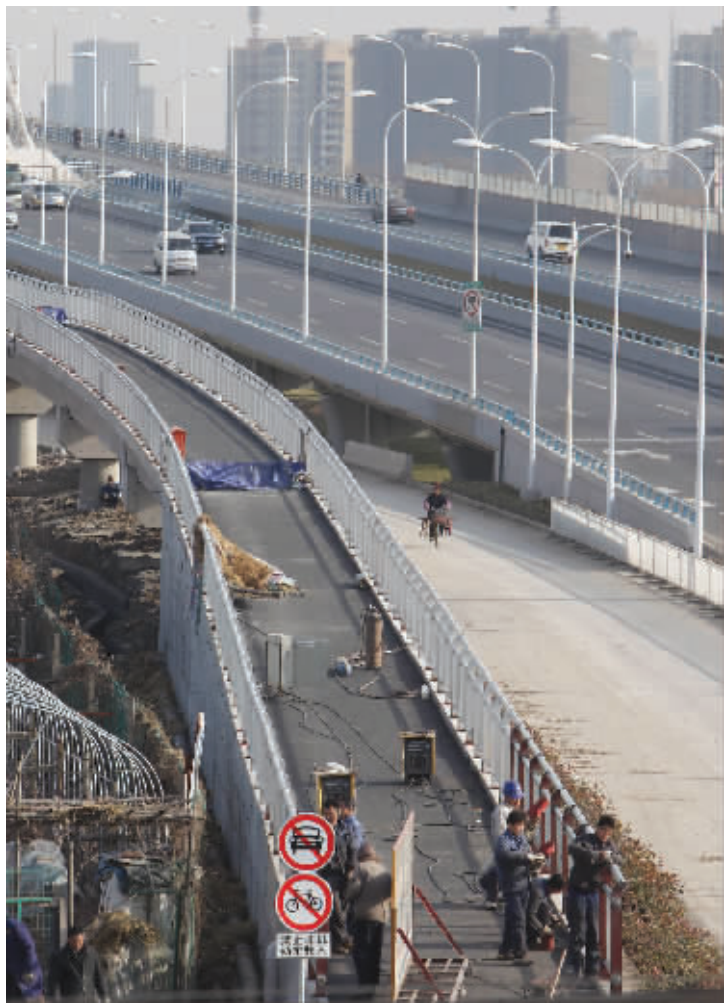
夹江大桥非机动车道正在进行扫尾工作 快报记者 洪波 摄
