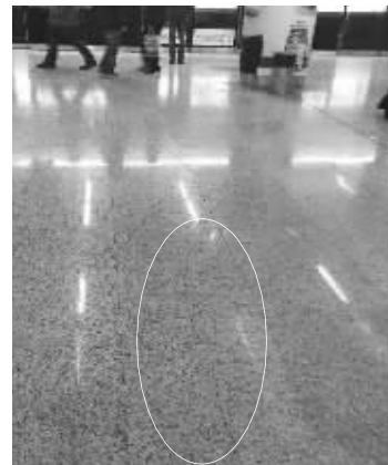
大理石地砖出现裂缝 快报记者 孙利侠 摄
