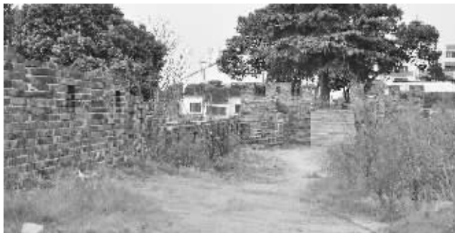
苏州市区胥门古城墙已残缺不全
