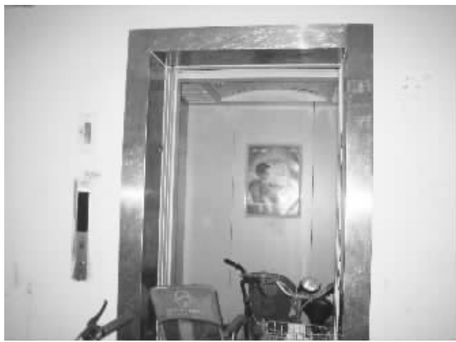
电梯已停了3天,不知什么时间能恢复供电
