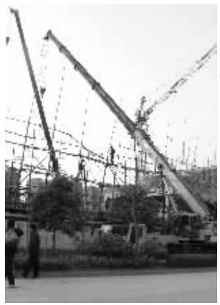
吊车正将倒下的塔吊吊走
