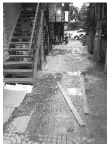
粪水漫溢的路面
