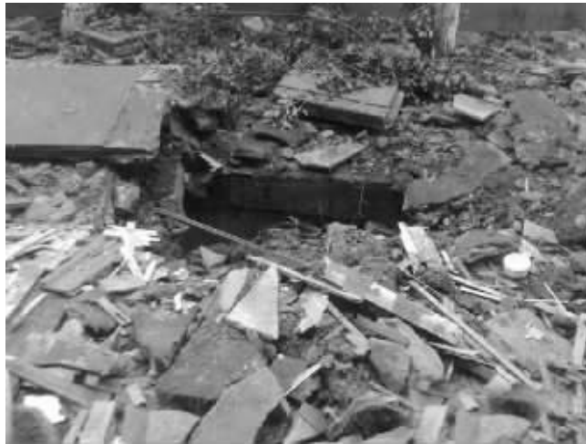
宜宾爆炸现场,外南街德济堂药房外,三处炸点中最大的一处
