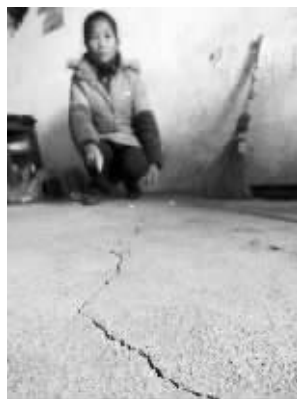
村民罗凤有家里出现裂缝 新华社记者 周科 摄
