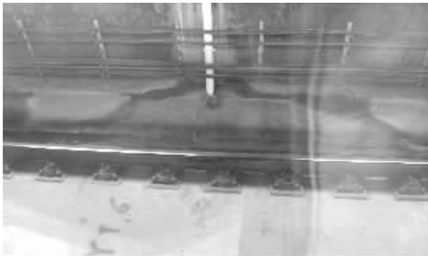
地铁公司称这是“结构渗水” 快报记者 钟寅 摄
