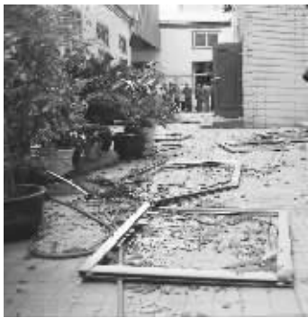
厂区窗户玻璃被震碎
