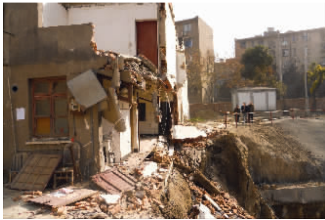
墙被挖掉一边,居民厨房坍塌
