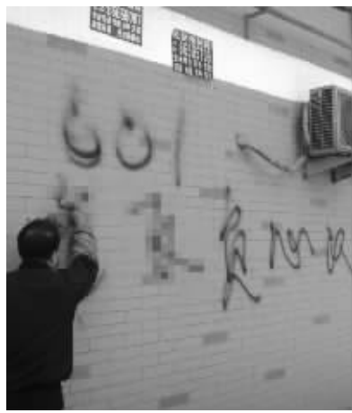
刚出新的楼面遭“涂鸦”
