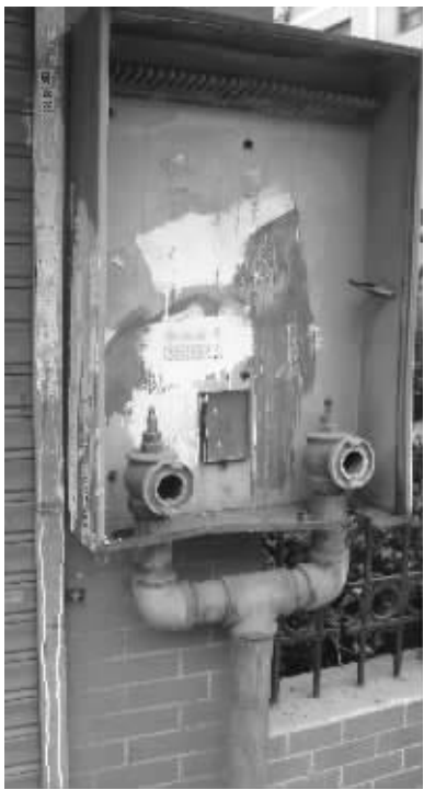
四个这样的消防箱都成了空箱
