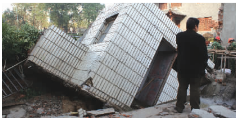
储藏室塌陷,大厦食堂只能暂停使用 快报记者 是钟寅 摄
