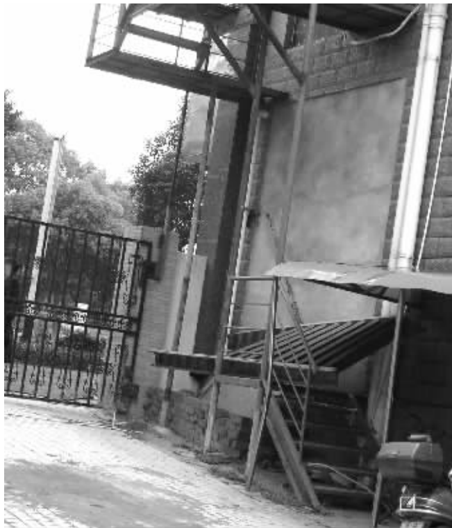
用作消防通道的铁楼梯已被拆除
