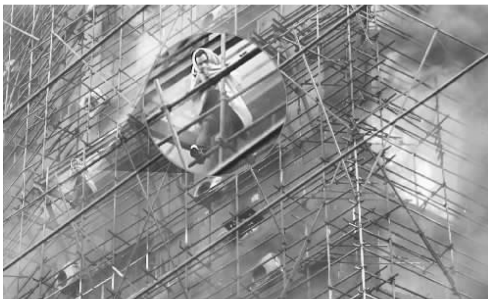
昨天下午,上海余姚路胶州路一栋正在进行外立面墙壁施工的高层住宅脚手架忽然起火。脚手架上一名住户在等待救援 IC供图
