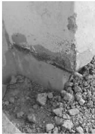
新房墙角钢筋外露让村民忧心
