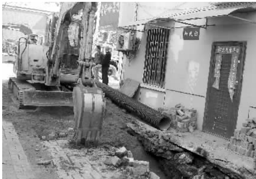
下关雨污分流工程,曾造成居民楼旁的地基塌陷
