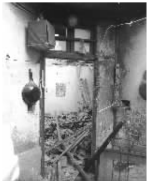
年久失修,百年老宅屋顶坍塌
