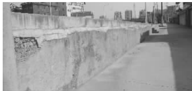
盲道与地面落差约1.2米,走在上面非常危险
