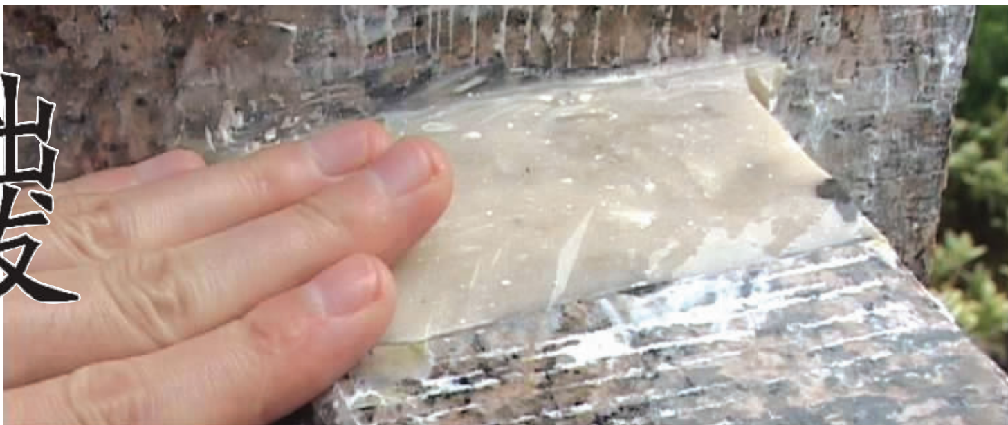
胶水糊起的裂缝
