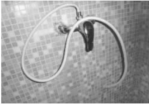
被损坏的水龙头
