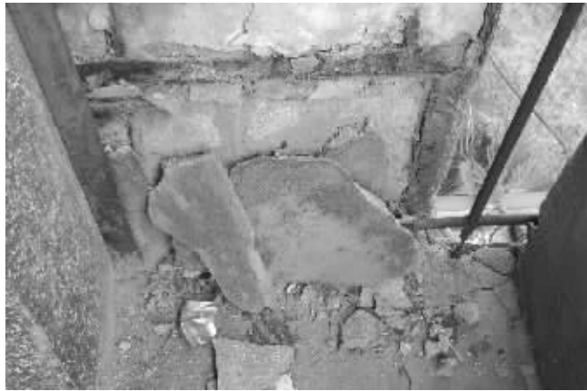
一碰就碎的水泥块随时会脱落
