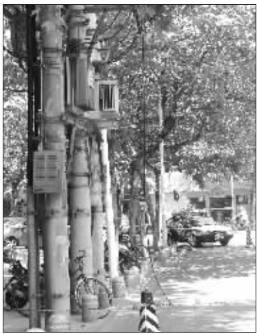
断裂的高压线已经垂落到地面
