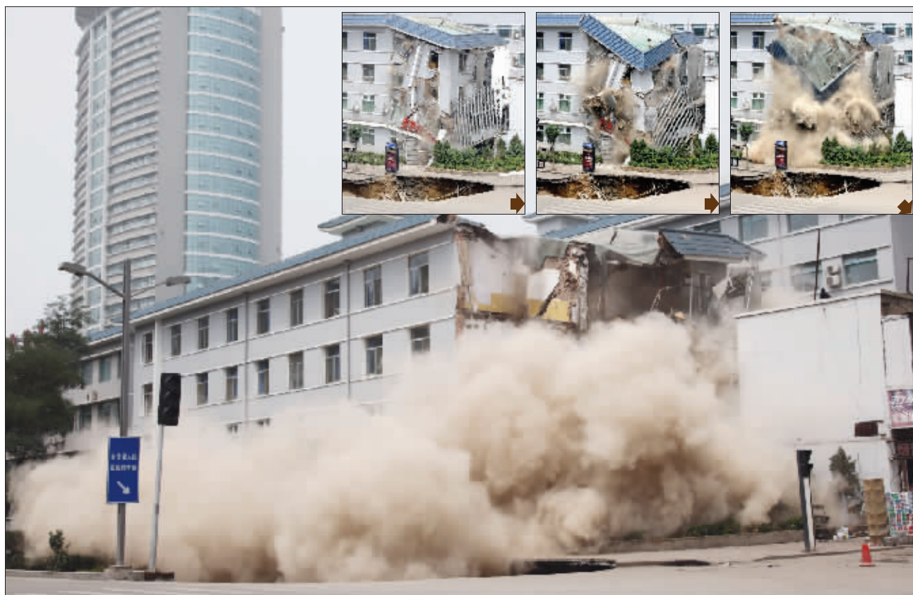
8月12日上午,太原市山西省人民医院所在位置的路面发生塌陷,9时多该院一门诊楼一侧发生坍塌 新华社发
