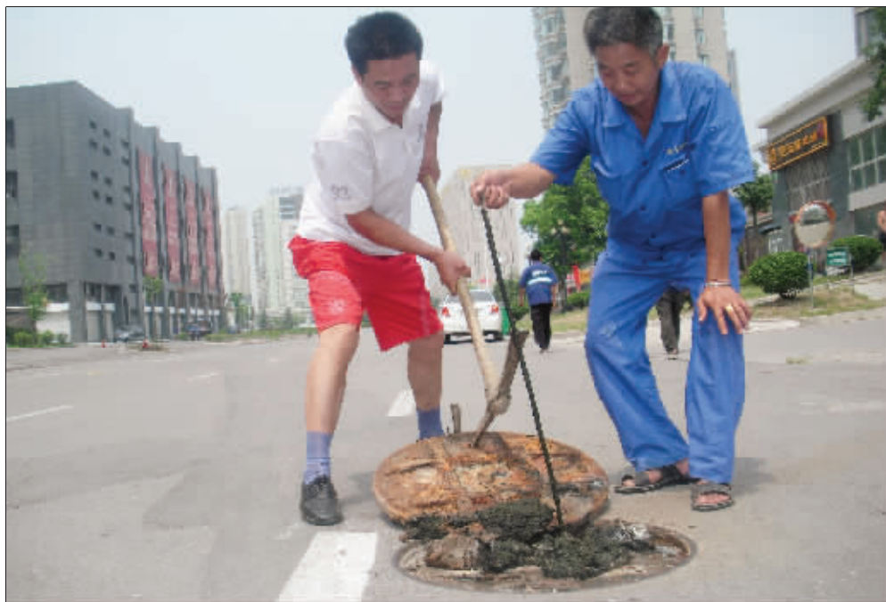
松花江大道上的污水井已经被完全堵塞
